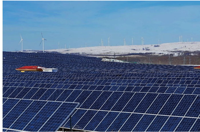
青海省玉树州“十三五”50.5兆瓦光伏扶贫项目 海拔最高的扶贫光伏电站
